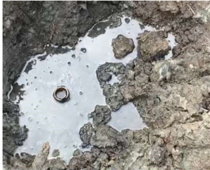
Afgescheurde ontluchter en lekverklikker nabij HD gasleiding en Prorail
