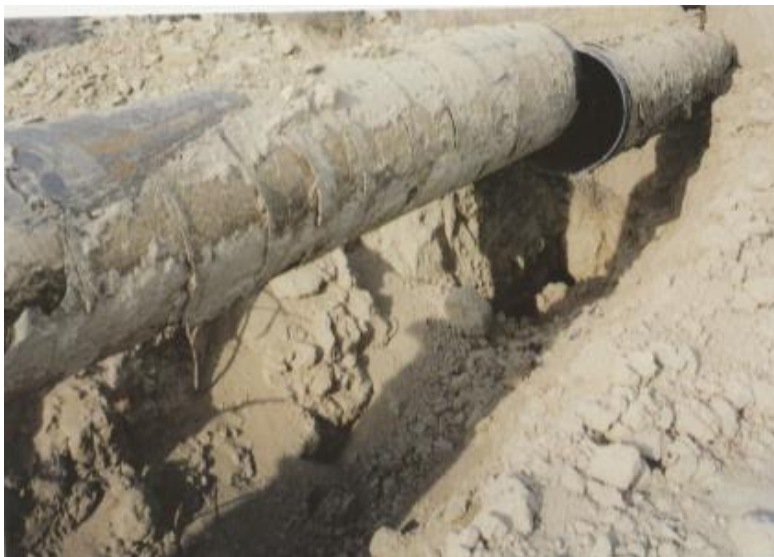
Figuur 3.4: Gescheurde rondlas ten gevolge van grondverzakking door mijnbouw (bron {ref.10}).
